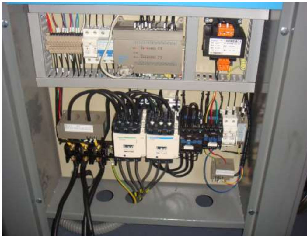
Блок серого цвета- система автоматической проверки системы PLC
